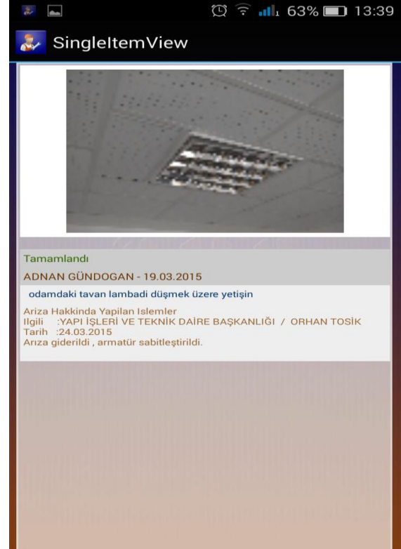
Şekil 7 Tamamlanan Arızanın Detayı
